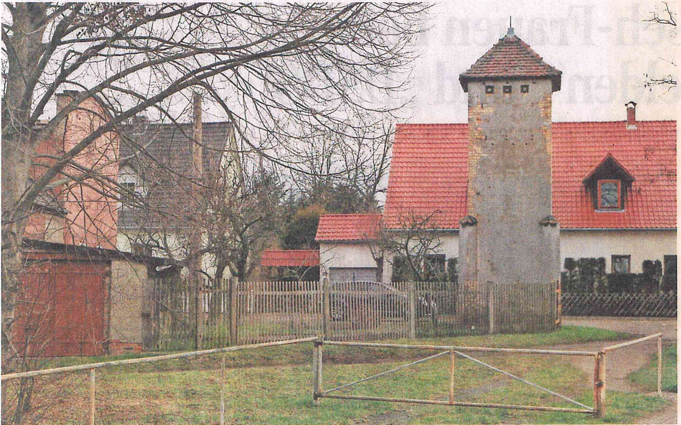
Die Rückseite des Trafoturms in Glesien offenbart, dass die Fassade einer dringenden Sanierung bedarf. Der Turm wurde um 1920 gebaut und ist heute Denkmal und ohne Funktion.
